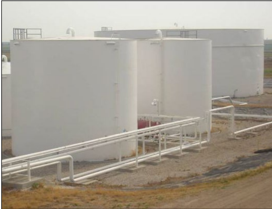
Figura 5.1: Tanque de almacenamiento interno con techo flotante
