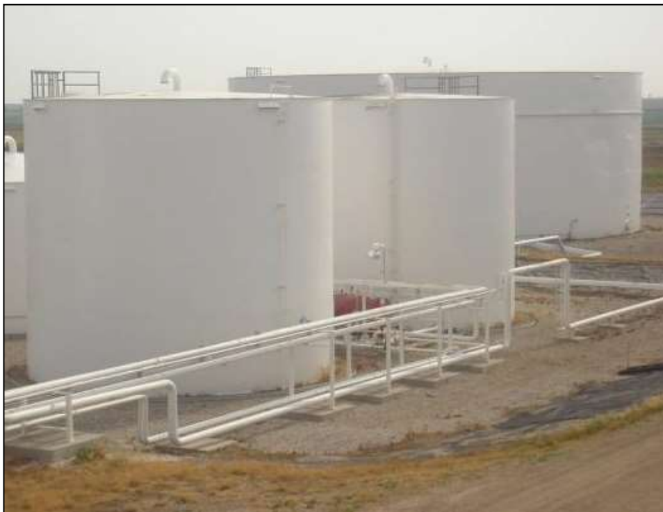
Figura 5.1: Tanque de almacenamiento con techo flotante interno
